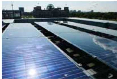
Solaranlage auf dem Dach des Bundeskanzleramtes Quelle: Bundesbildstelle Bienenr
